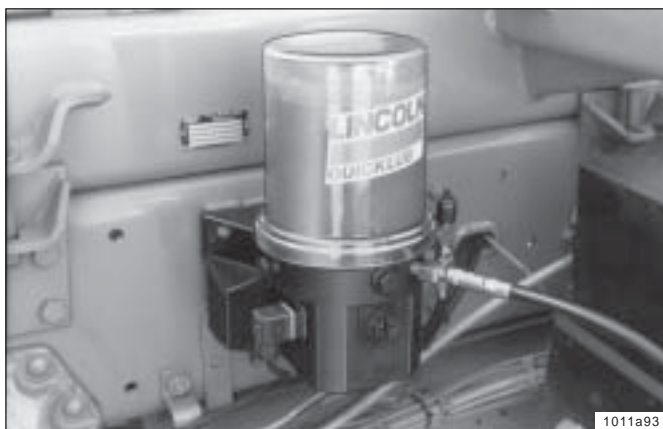
Abb. 21 - Behälter der Pumpe befüllen
